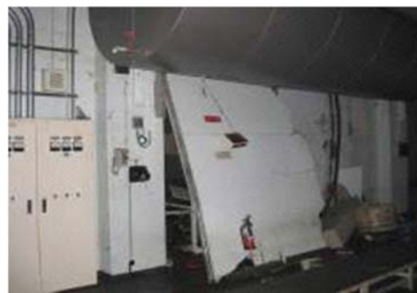
電力設備(1F)が大きく損傷
