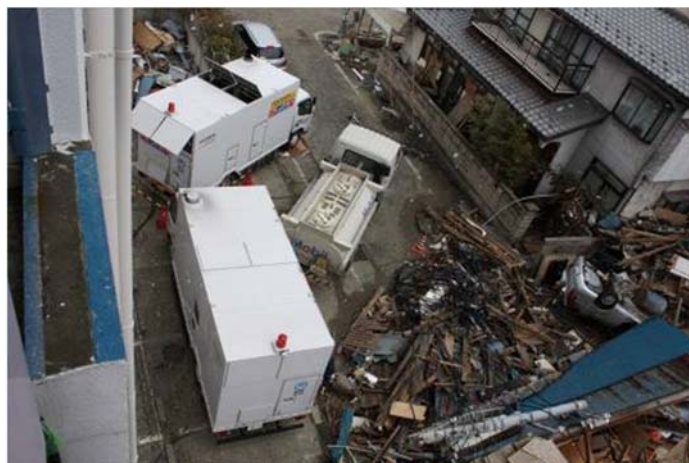
移動電源車・タンクローリーの配備により、通信サービスを復旧(3/19) (4/24に商用電源が回復するまで、移動電源車からの給電を継続)
