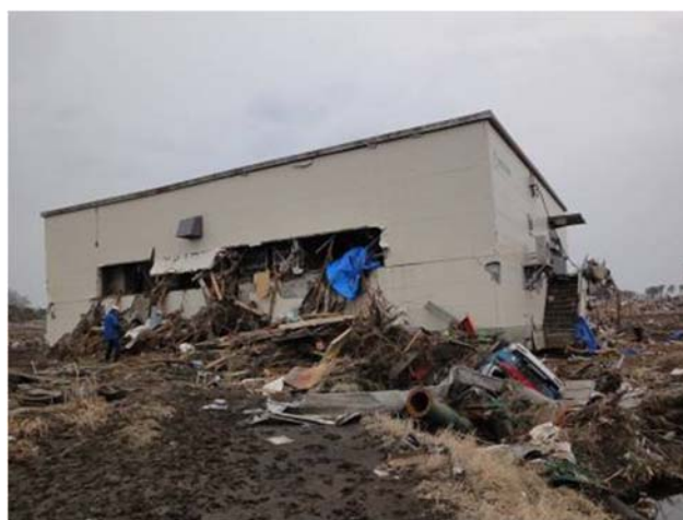
津波により流失し、基礎台ごと約500m流され全壊
