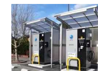
EVバス充電設備
