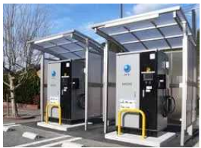
充電施設 蓄電池
